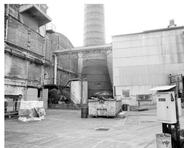
Détail du socle de la cheminée d'usine, construite en 1897. Phot. Thierry Lefébure IVR22_19926000337X
