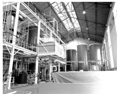
Chaufferie : vue intérieure. Phot. Thierry Lefébure IVR22_19926000369X
