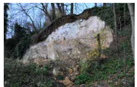
Fin mai 2012, un rocher de plus de 1000 tonnes s'est détaché, au-dessus de la rue Germaine Sibien, et menaçait de s'écrouler ; il a été concassé par une entreprise spécialisée. Ci-dessus, une vue du « trou » qu'il a laissé.
