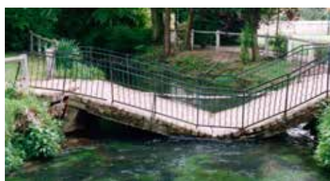
L'effondrement de la passerelle du parc de la mairie, le 12 mai 2004.
